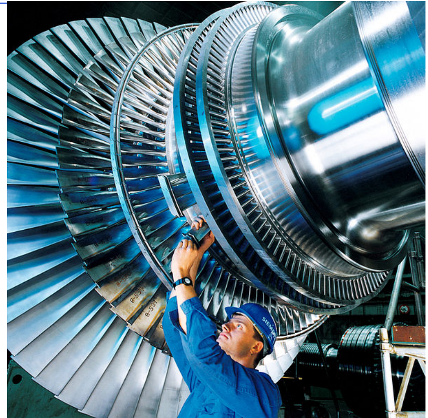
Bladen i en ångturbinsrotor under service
